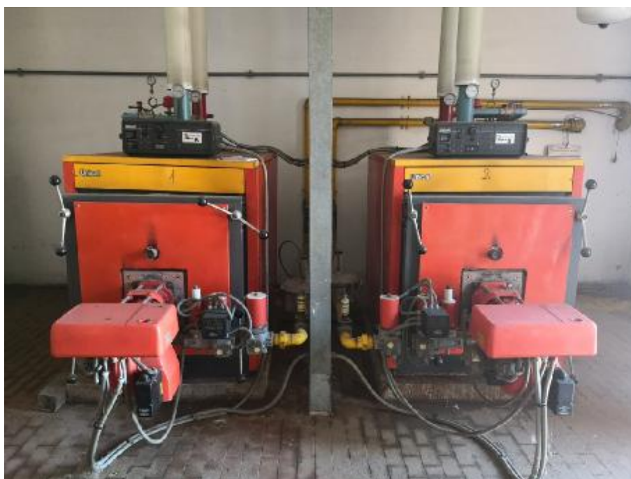
figura 3 – generatori di calore GC1 e GC2
