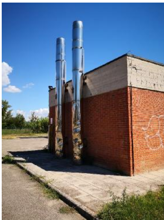
figura 2 – centrale termica CT
